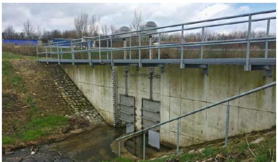
Komplexe Bauwerkssteuerungen lassen sich in NASIM detailliert abbilden und optimieren. (Bild: Hydrotec)
